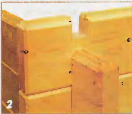
Возведение стен из шпунтованных досок с заранее сделанными пропилами не представляет особых трудностей.
